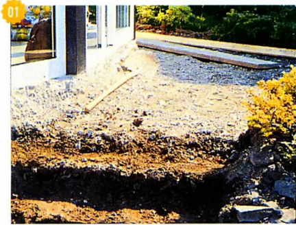
↑ Чтобы покрытие служило как можно дольше, необходимо правильно подготовить основание. Нижний его слой — дренажный, из уплотнённого щебня.
